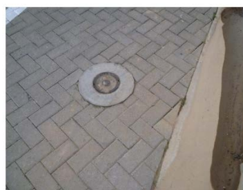
DETALLE DE TAPA DE VALVULAS EN CALLE DE ADOQUINES.
